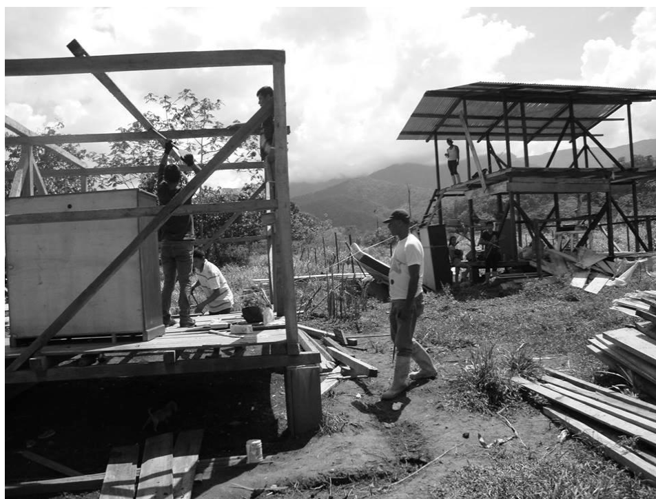
Derrocamiento de viviendas en los desalojos forzados del 30 de Septiembre de 2015. Autoría: Cascomi
