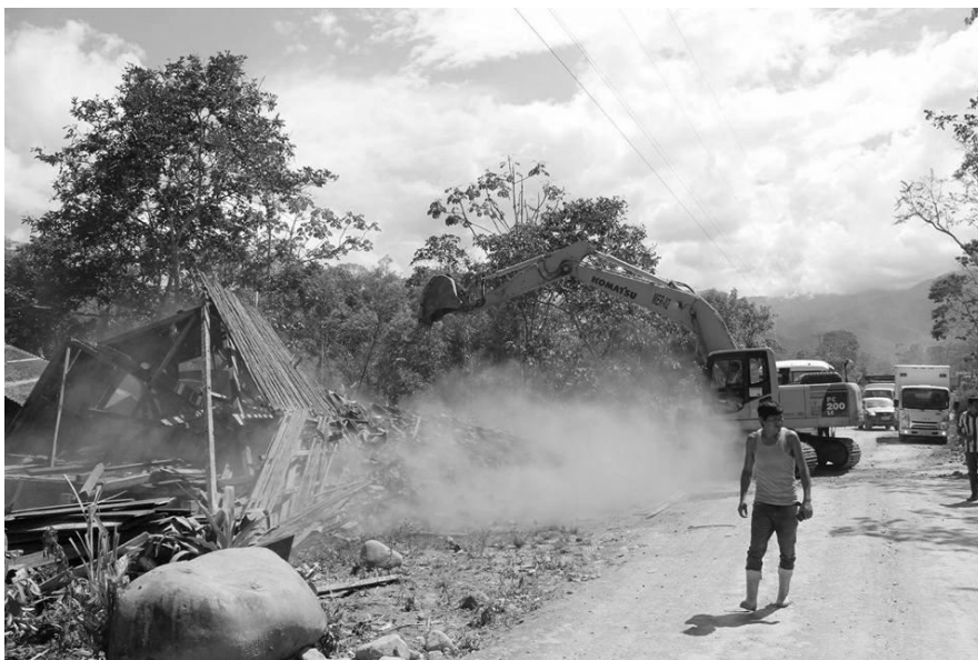
Propiedades destruidas con maquinaria durante los desalojos forzosos del 16 de Diciembre de 2015. Autoría: La República
