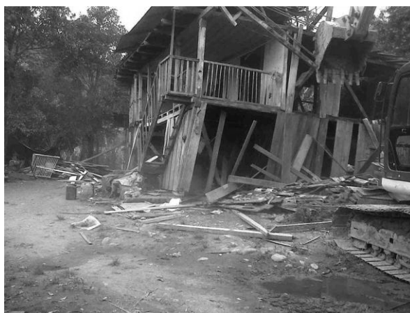
Viviendas derrocadas en el segundo desalojo en Tundayme.
